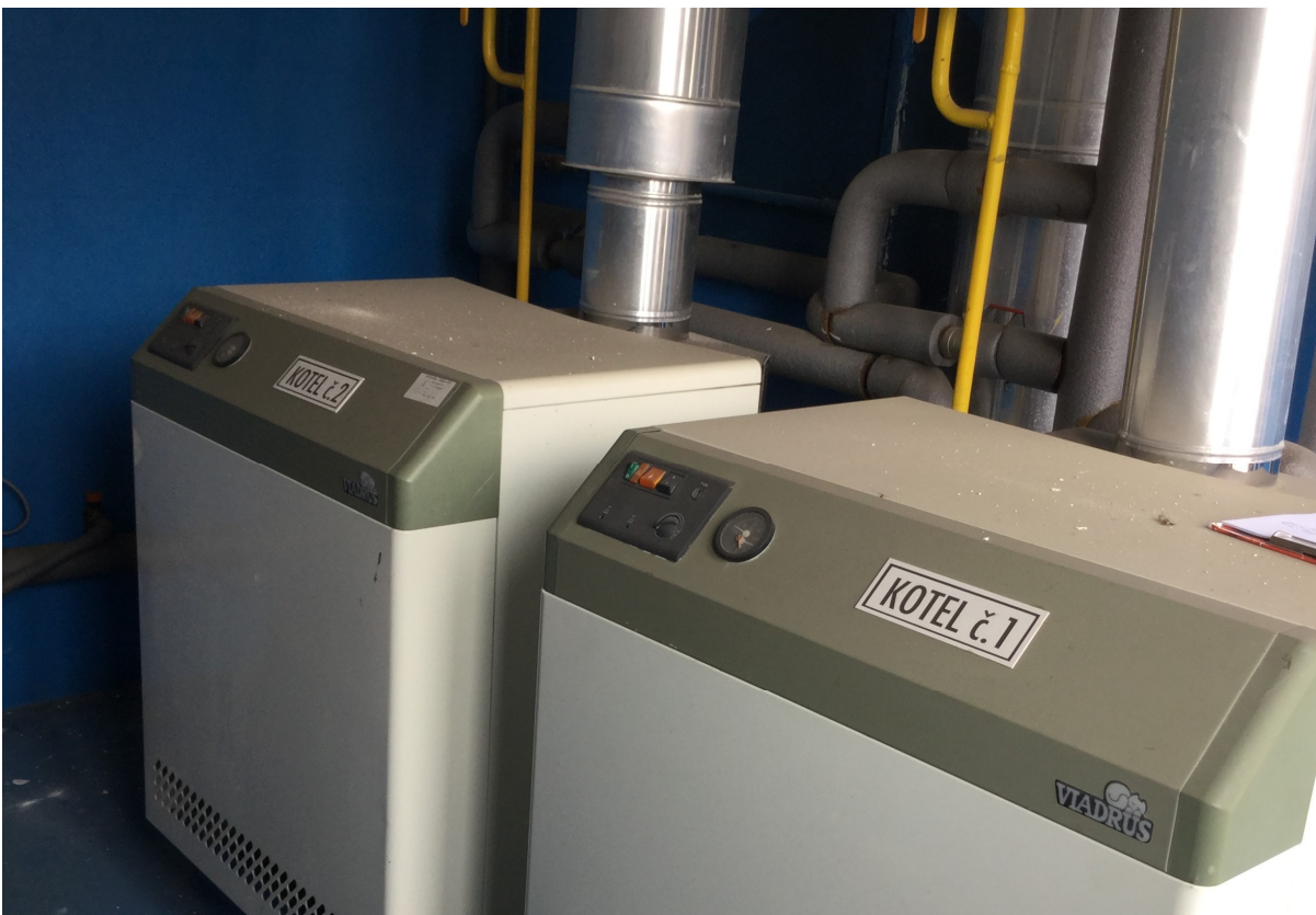
Kotelna v budově část A
