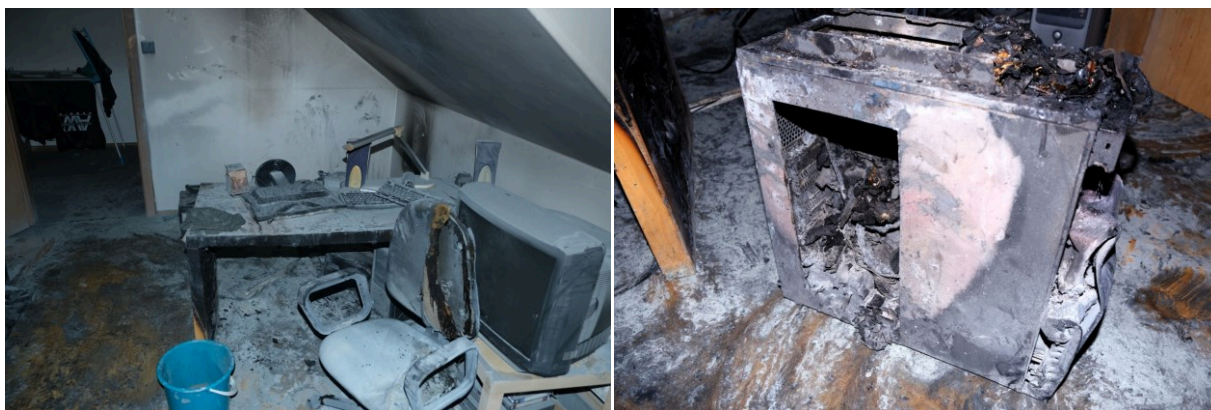
Záběry pořízené při vyšetřování požáru
