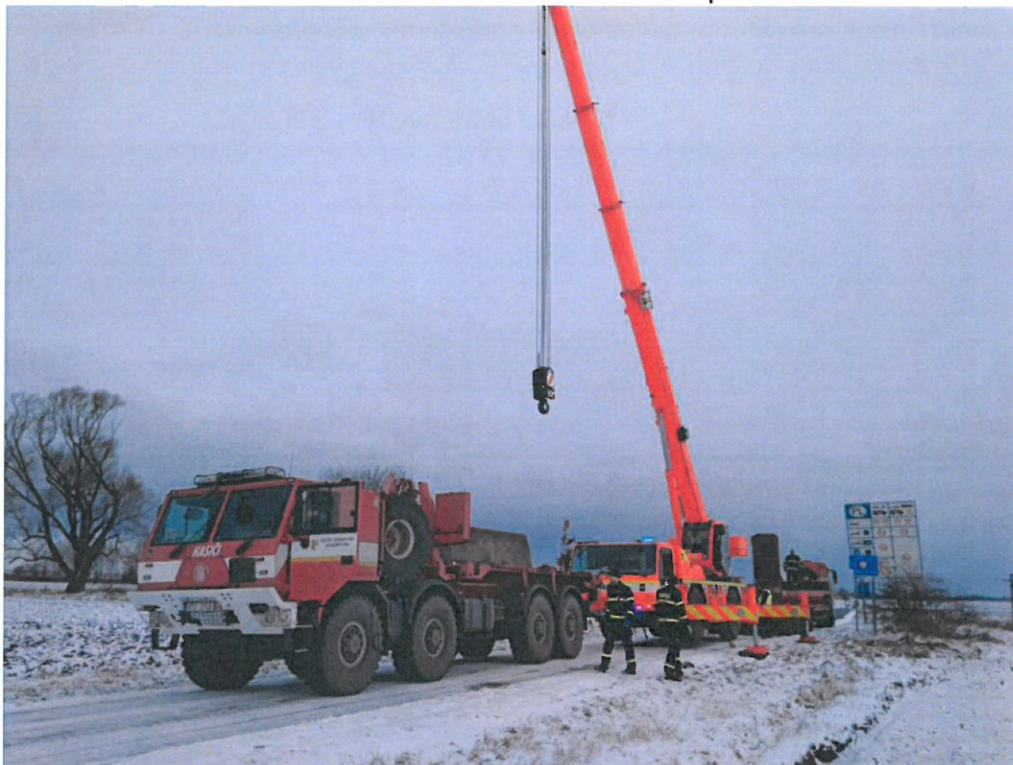
Instalace mobilních zátarasů na hraničních přechodech
