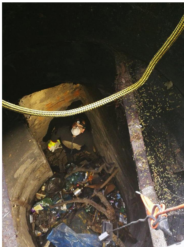
vyklížení zvonové šachty plné odpadu
