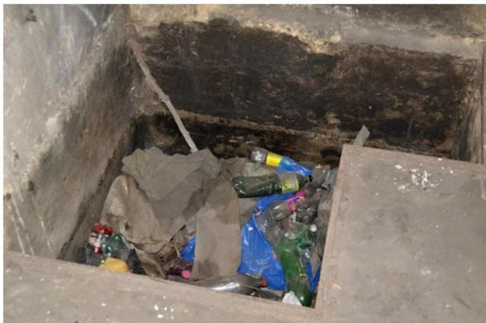
Černé skládky uvnitř objektu, noclehárna bezdomovců a feťáků
